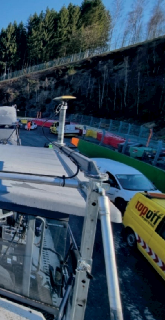
Rabotage sur mesure et pose d'un nouvel asphalte sur le célèbre circuit belge de Spa-Francorchamps.
